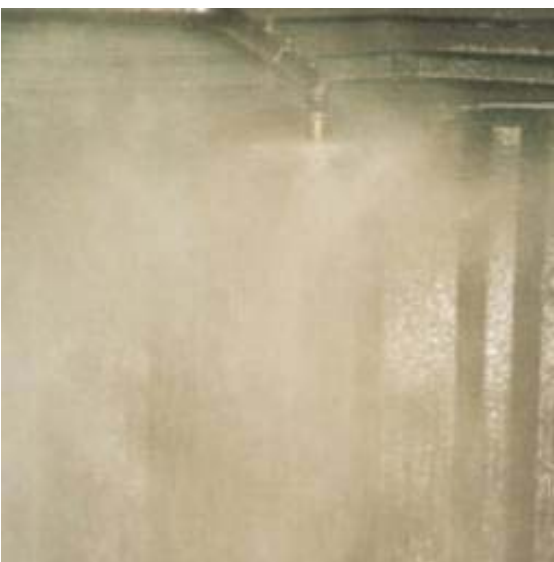
Fig. 11 Impianto Sprinkler in funzione.
